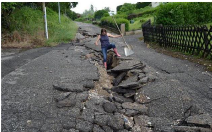
Figure 3: rue Saint-Florent à Niederhaslach - Source : DDT 67
